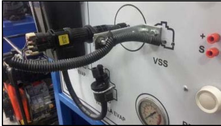
Figura 38. Instalación de sensor VSS Autor: Julio Obregón
