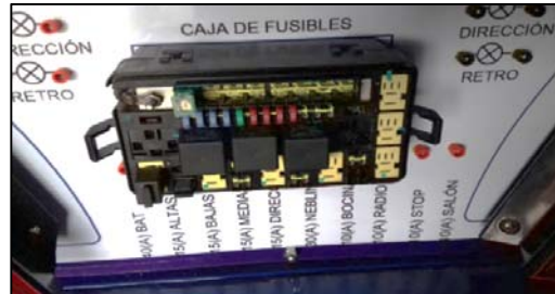
Figura 38. Caja de fusibles
