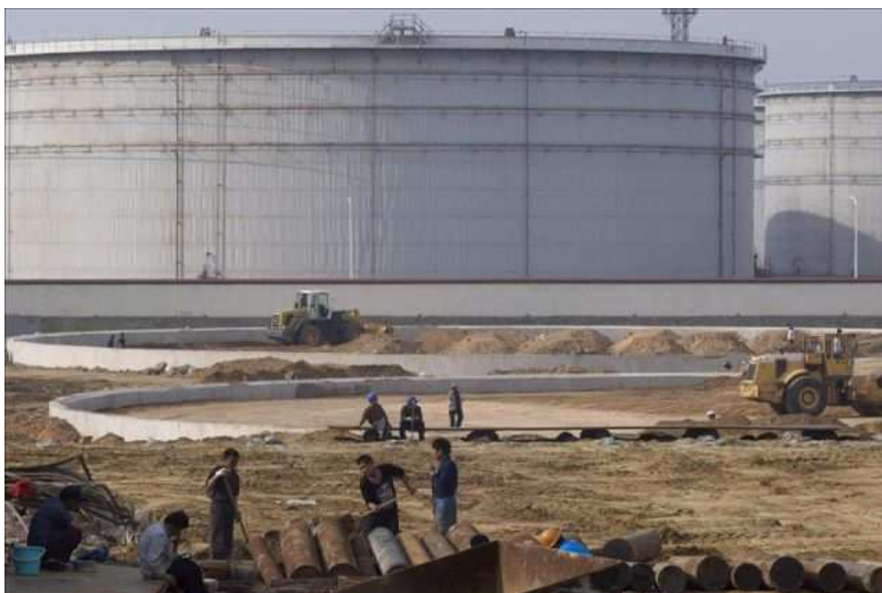
Fuente: TANQUES DE RESERVA DE PETROLEO (2016)
