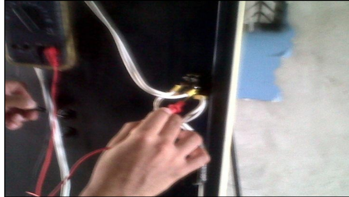
Figura 90: Prueba de corto a masa en interruptor de parada de emergencia.
