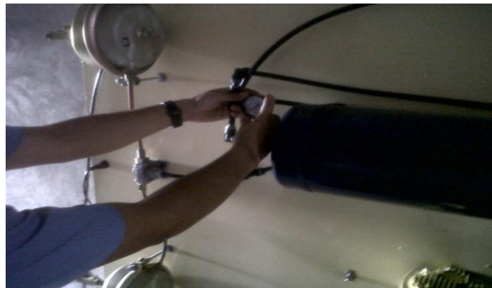
Figura 74: Verificación de manómetro.
