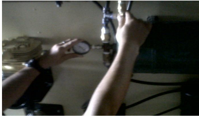
Figura 75: Verificación de manómetro.
