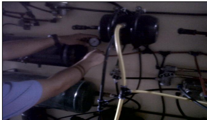
Figura 79: Verificación de manómetro.
