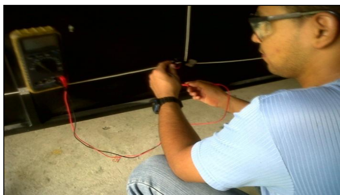
Figura 99: Prueba de alimentación 12V en líneas de voltaje.
