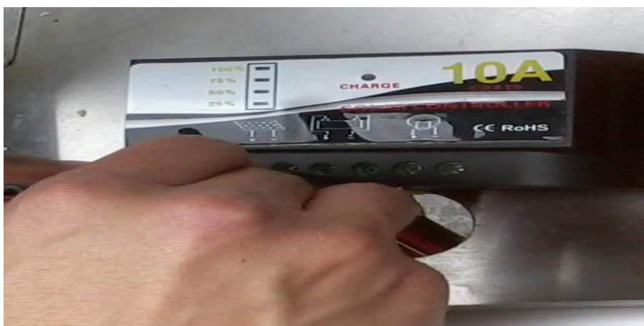
Fig. 4.6 Medición de voltaje del Controlador Fotovoltaico
