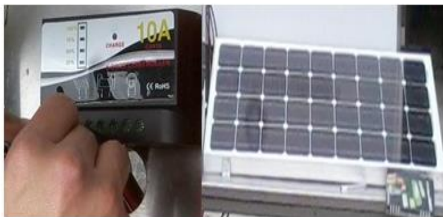
Fig. 3.36 Conexión Generador Fotovoltaico con el Controlador del sistema
