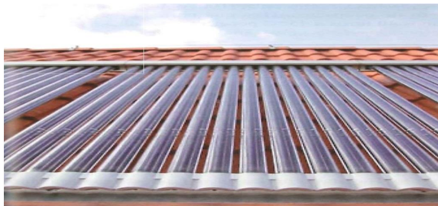
Fig. 2.6 Colectores solar-térmicos sobre un tejado
