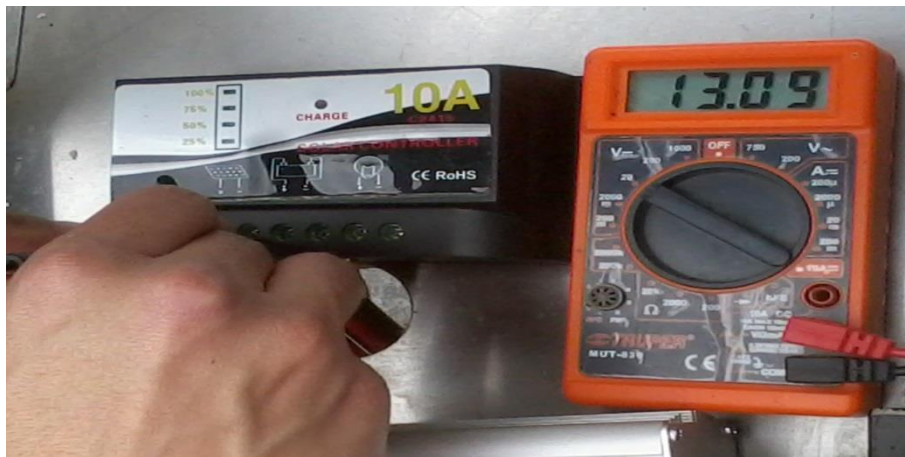
Fig. 4.4 Medición de voltaje del Panel solar fotovoltaico
