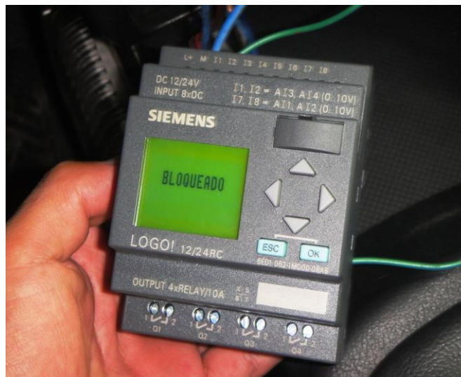
Fig.4.7 Verificación del funcionamiento del circuito electrónico en la PLC
