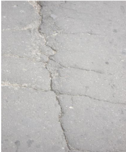
Fisuramiento en borde
