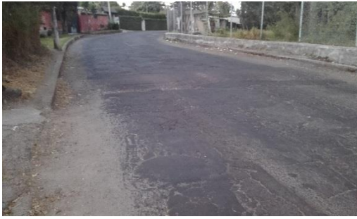
Fisuramiento Piel de cocodrilo
