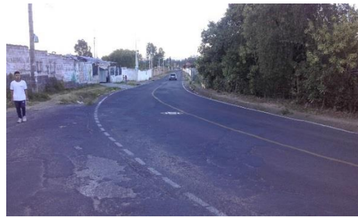
Fisuración en bloque
