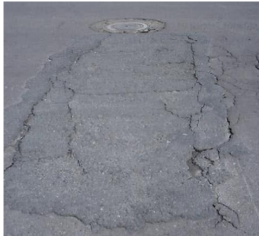
Fisuramiento en bloque
