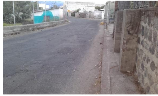
Fisuramiento en bloque
