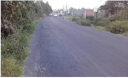
Fisuramiento de borde
