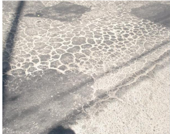
Fisuramiento Piel de cocodrilo
