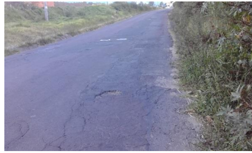
Fisuramiento en bloque
