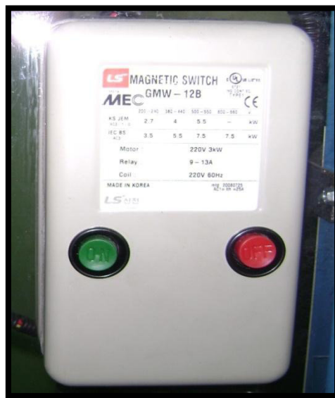
FIGURA 3.2 ARRANCADOR DEL MOTOR FUENTE: DÍAZ, MANJARREZ
