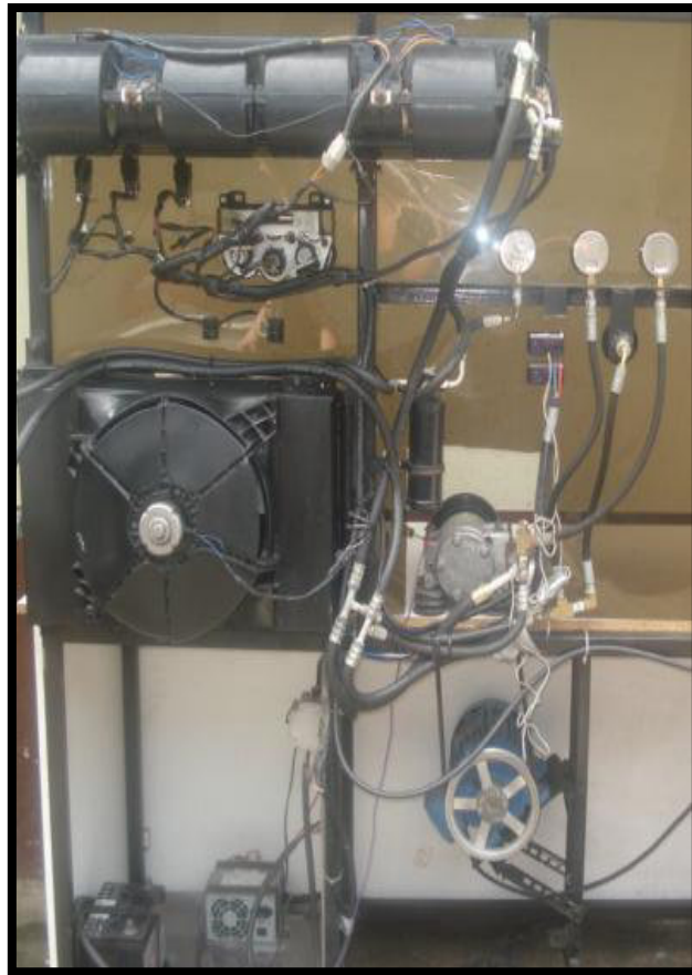
FIGURA 3.37 CABLES ELÉCTRICOS FUENTE: DÍAZ, MANJARREZ
