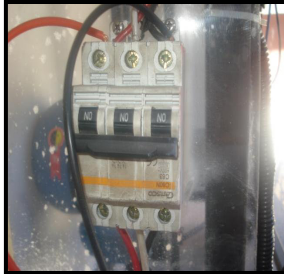
FIGURA 3.3 INTERRUPTOR TRES FASES FUENTE: DÍAZ, MANJARREZ
