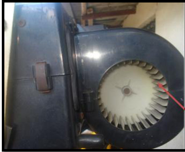
FIGURA 3.11 EVAPORADOR FUENTE: DÍAZ, MANJARREZ
