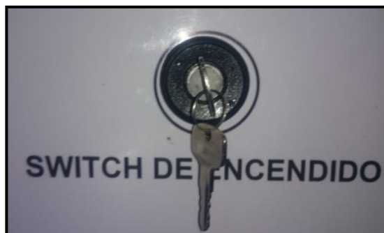
Figura 38. Instalación del switch de encendido Autor: Jonathan Olivo
