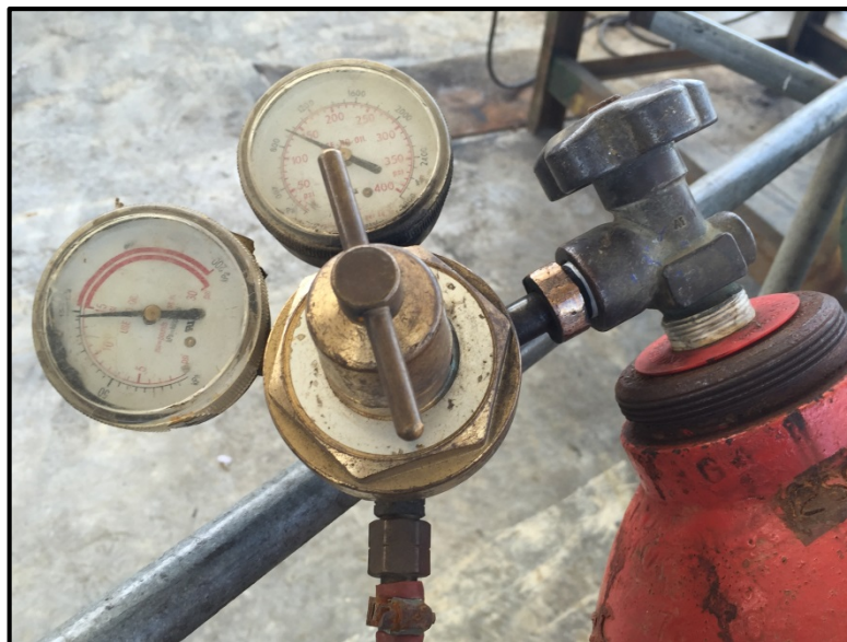
Figura N° 14. Manómetros de presión en mal estado
