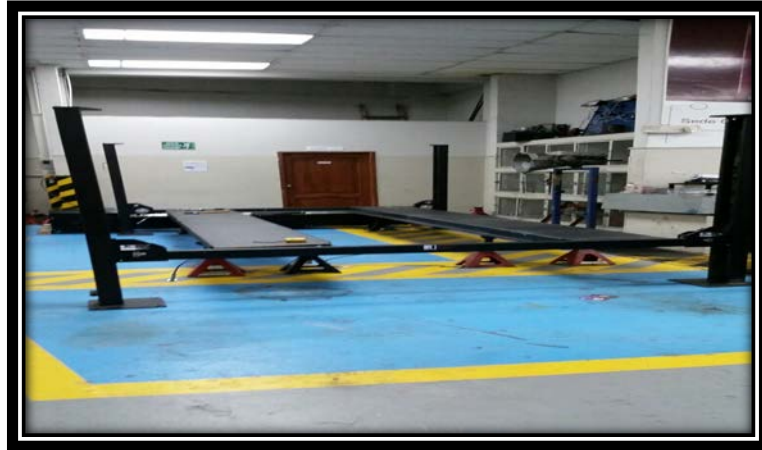
FIGURA 14 Instalación del Elevador de Cuatro Postes Fuente: UIDE – Talleres FIA extensión Guayaquil Editado por: Cesar Salazar
